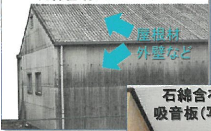
石綿含有スレートボード
